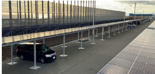
駐車場設置事例 (太陽光出力410.82kW)
